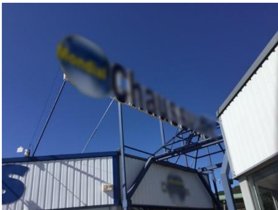
Enseigne sur toiture ou terrasse en tenant réalisée sans dissimuler ses fixations, Solliès-Pont, Mars 2018
