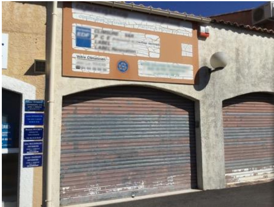
Mauvais état d'entretien de l'enseigne, Solliès-Pont, Mars 2018
