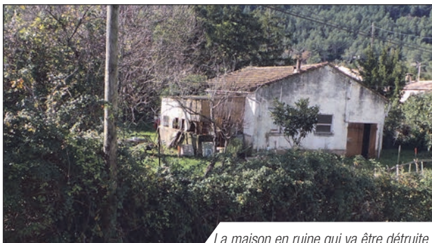
La maison en ruine qui va être détruite
